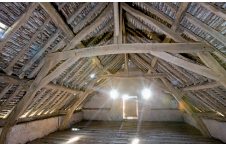
La Hanterie, charpente à entrain retroussé* sur jambes de force (étables, vers 1850)
