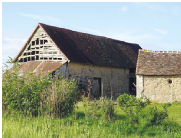
Ancienne ferme des Petits Jauneaux avec ses bâtiments en torchis et en bauge (© Perche Sarthois).
