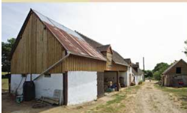
> 2 L'Ardrillière à Rouperroux-le-Coquet. Le logis est prolongé par une succession d'étables et de remises construites à différentes époques. L'étable en vis-à-vis est ajoutée au tournant des XIX e et XX e siècles.
