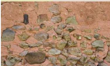
> 2 L'enduit unifié et protège le parement du mur en moellons, sa couleur est fonction du sable utilisé. Briozes-lès-Sables, Le Petit Verger.
